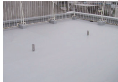
脱気筒の設置例
