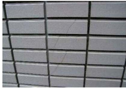
▲タイルの割れ
