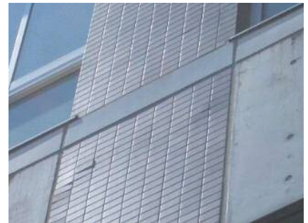
▲タイルの浮き、はく離
